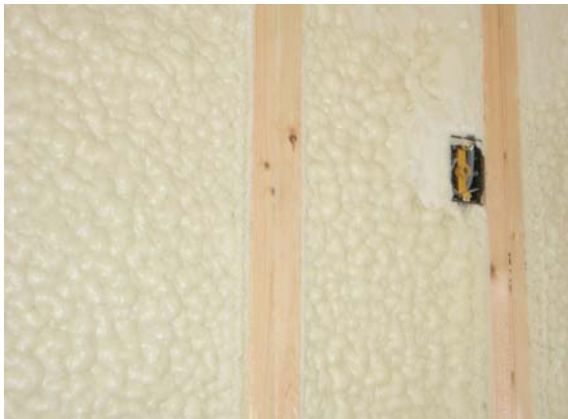
コンセントBOX周り
